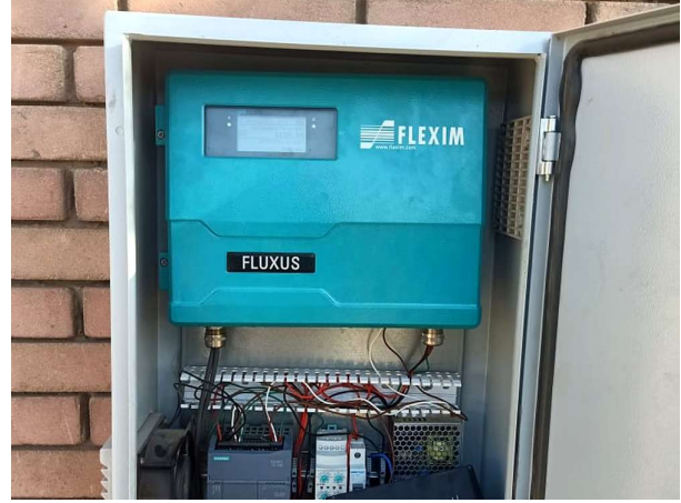
وحدة القياس ووحدة التحكم ونقل البيانات داخل الصندوق الميداني Transmitter, controller and data-transmission unit in the field cabinet
