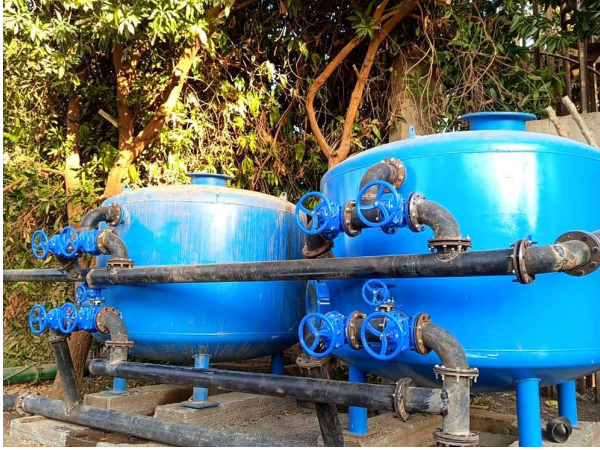
وحدات الترشيح ومحابس التشغيل بالمحطة Filtration vessels and operating valves
