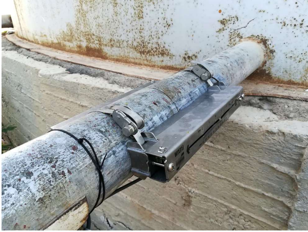
حساسات القياس اللاصقة (Clamp-on) مركبة على الخط الناقل Clamp-on ultrasonic sensors installed on a transmission main
