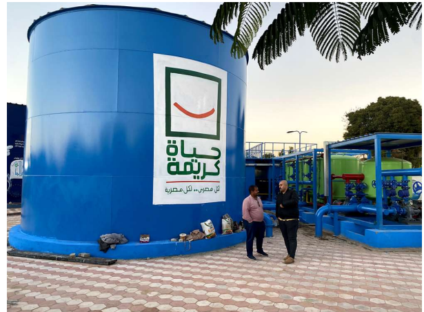
المحطة بعد الاستكمال والتشغيل The plant after completion and commissioning
