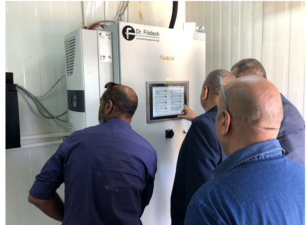
لوحة التحكم بمنظومة رصد الانبعاثات أثناء التشغيل Emission monitoring system control cabinet during commissioning
