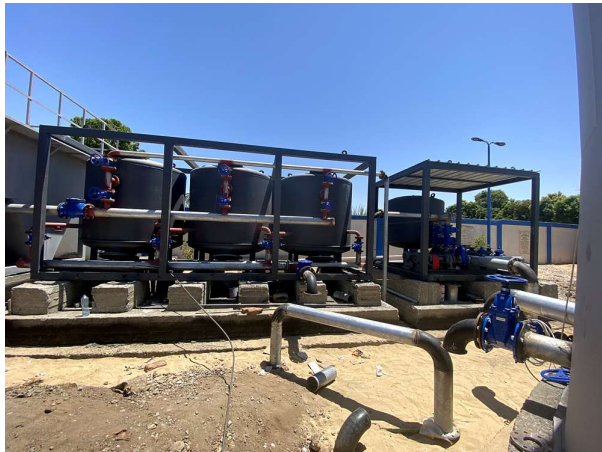
وحدات الترشيح وشبكة المواسير بعد التركيب Filtration units and pipework after installation
