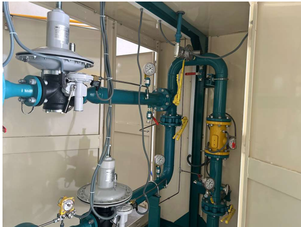
منظومات الضغط وخطوط محطة تخفيض ضغط الغاز الطبيعي Pressure regulators and pipework inside a gas pressure reduction station
