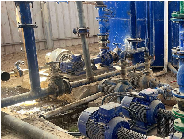
خط الطرد ومجموعات الضخ داخل المحطة Discharge manifold and pump sets inside the plant
